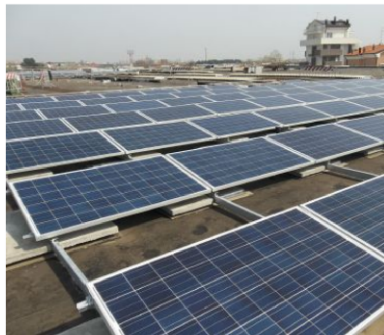
Un impianto fotovoltaico
